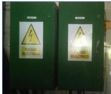
Uso de Señalización "Riesgo Eléctrico". Ex Sala de Máquinas.
